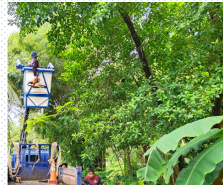
ตัดไม้ทับสายไฟที่ ม.4
