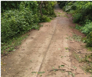
ตัดไม้ล้มขวางถนนที่ ม.2 หลังจากดำเนินการ
