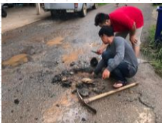
ประปารั่ว ไต่ถนนที่ ม.5
