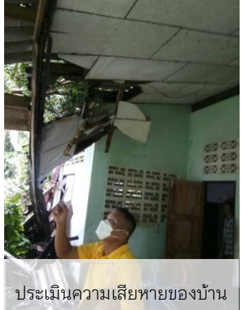
ตัดต้นไม้ล้มทับหลังคาบ้าน ม.2
